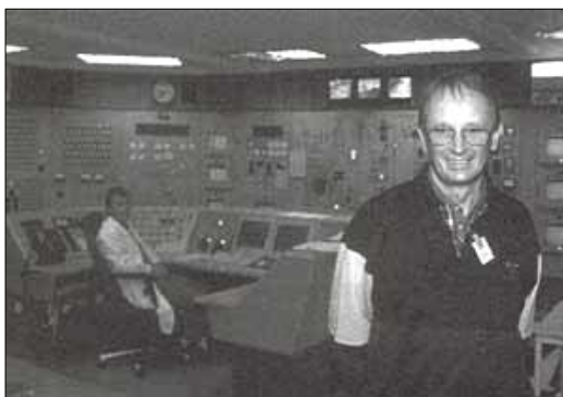
Helge Smitdt-Olsen var i en årrekke sikkerhetssjef ved Haldenreaktoren. Her er han i reaktorens kontrollrom. Foto: Roger Grøndalen/ Bellona.
